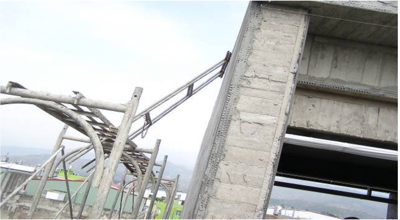
5. 將移動梯、合梯置於施工架上使用，有墜落之虞不符合規定之照片。
