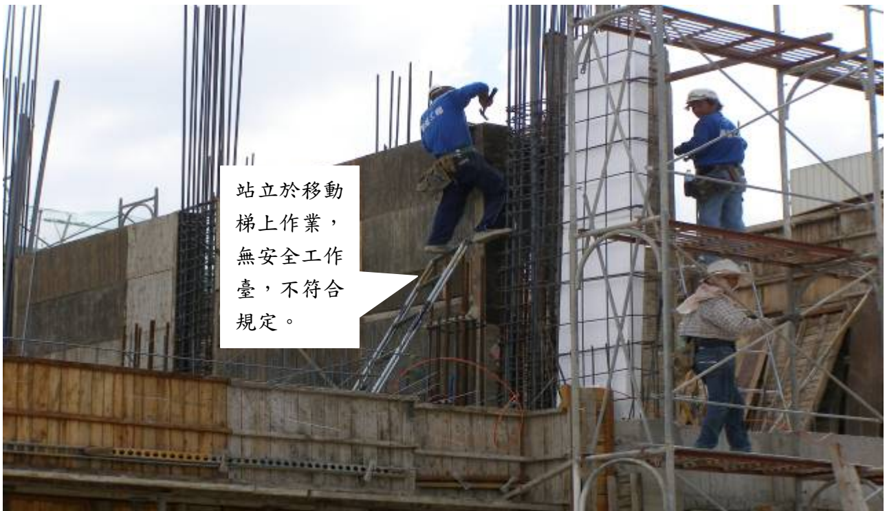
6. 站立移動梯、合梯頂上作業，無安全之工作臺，不符合規定之照片。
