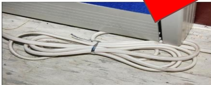
延長線擠壓造成變形
