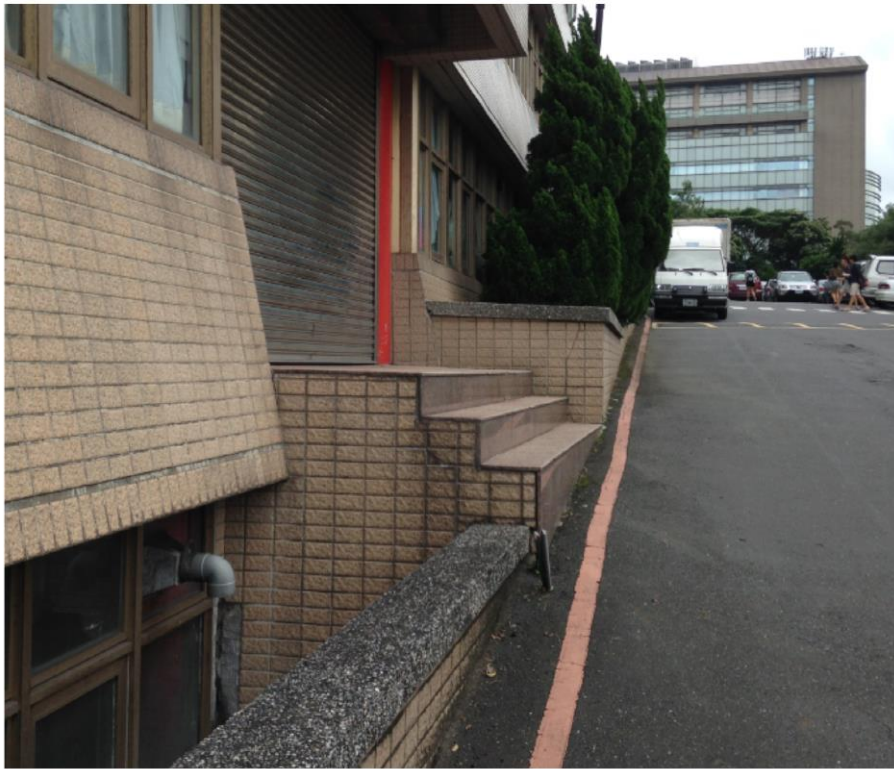
未設置安全護欄
