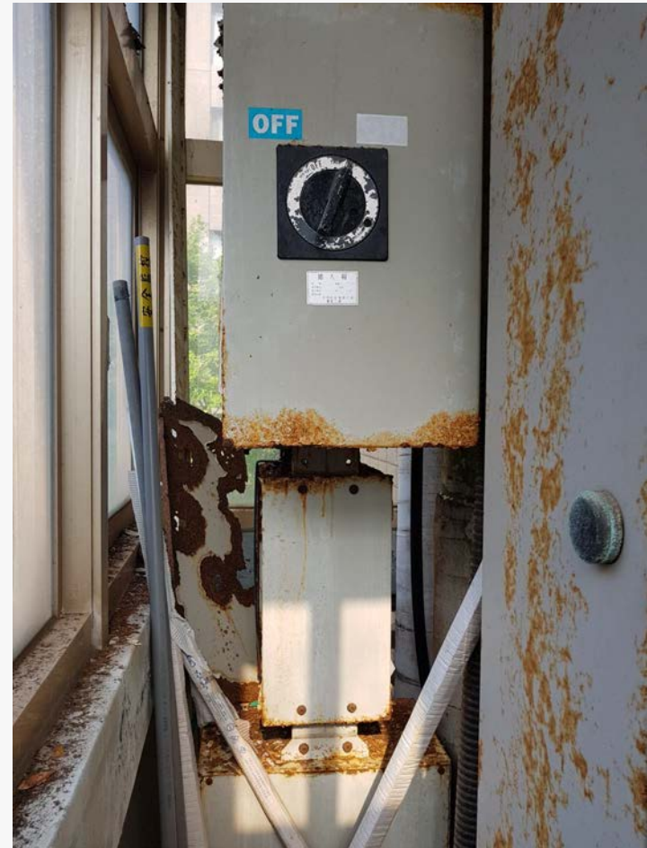
匯流排鏽蝕現況
