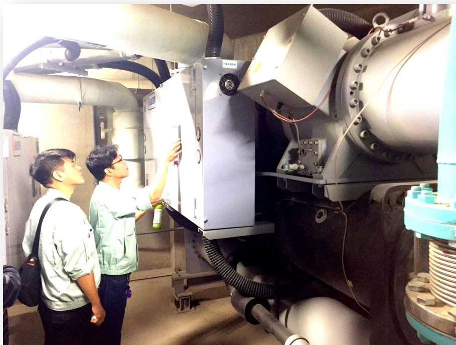
空調儀表測試檢查
